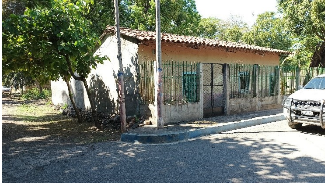
Fig. 9. Vivienda de mampostería confinada inundada. Fuente: elaboración propia, DOA-MARN.
