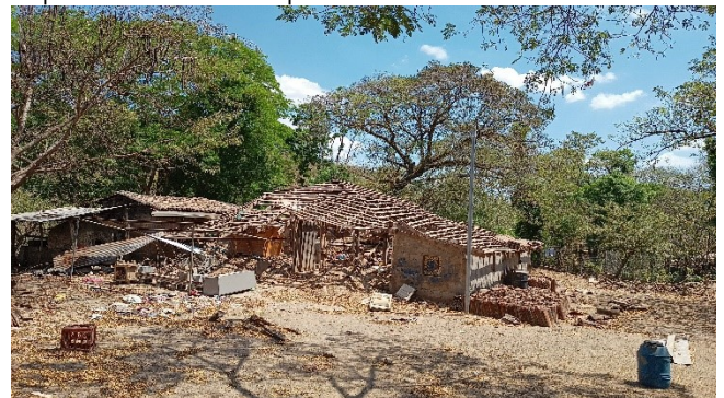
Fig. 8. Vivienda de adobe colapsada. Fuente: elaboración propia, DOA-MARN.
