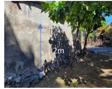
Fig. 24. Registro de máxima crecida en vivienda de mampostería reforzada. Fuente: elaboración propia, DOA-MARN.
